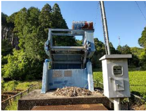
老朽化した半済除塵機
